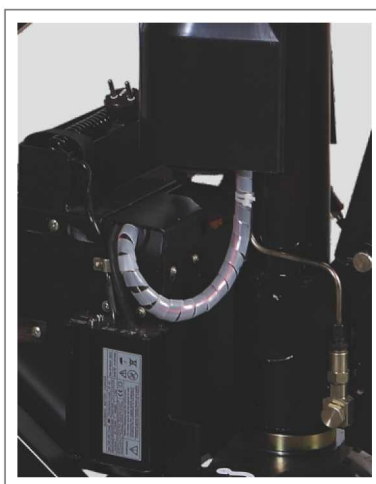
Cableado fiable con protección. El cargador incorporado proporciona una mayor autonomía e incrementa el rango operativo.
